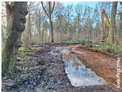
Begin van de werkzaamheden, ter hoogte van de plek waar beide lopen weer samenkomen.
